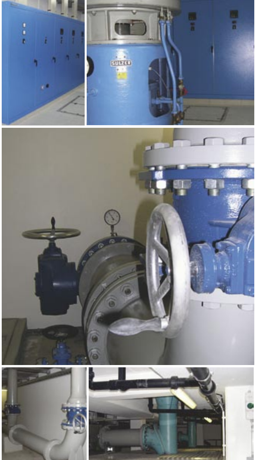
Bilder des neu sanierten Pumpwerkes Männedorf
