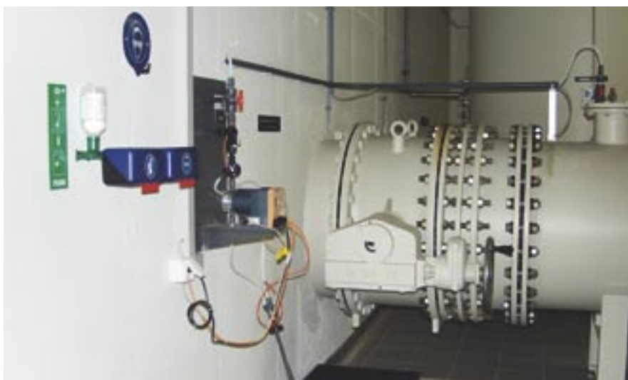
Dosieranlage im Pumpwerk Sonnenfeld
